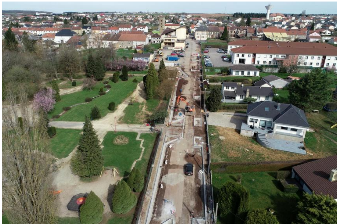
A Lesty, la rue du Commandant-Spicq, actuellement en travaux, passera en sens unique. Elle ne sera plus que descendante, dans la perspective de la reconfiguration du centre-ville. Photo DR
