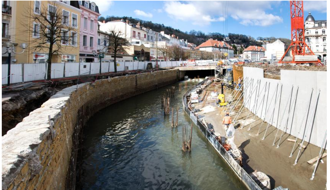
La réflexion concerne la globalité du centre de Longwy-Bas. Elle prend en compte les projets urbains du cœur de ville et ses fonctions essentielles, ainsi que la poursuite de la découverte de la Chiers, avec la renaturation et la lutte contre les inondations. Photo DR
